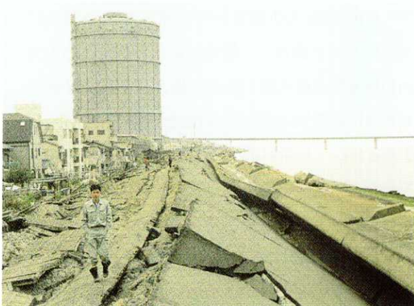
阪神淡路大震災で破壊された淀川左岸河口部
