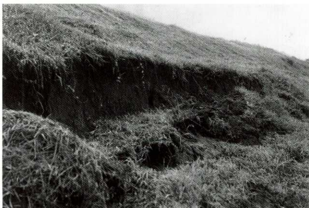
昭和35年の豪雨で崩壊した北島地区の裏法堤防
